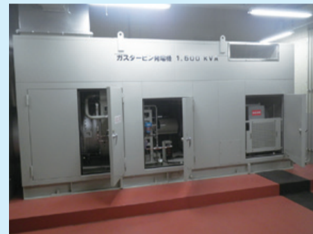
▲非常用発電機
