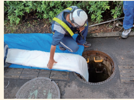
▲下水道管を補強する材料をマンホールから入れている様子
